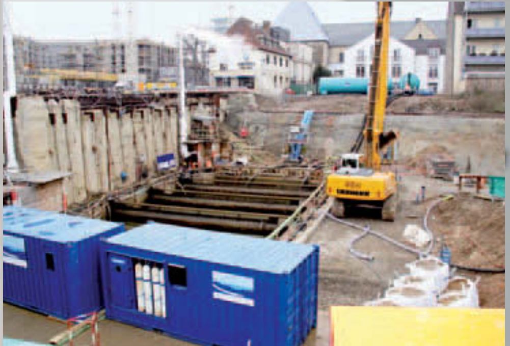
Die „Wunde von Köln“: Die Stadtarchiv-Einsturzstelle am Kölner Waidmarkt ging bundesweit durch die Presse. Hier entstehen Wohnungen, Büroräume, zwei Hotels und Gewerbeflächen. Bauherr: der Frankfurter Projektentwickler „Fay Projects“.
